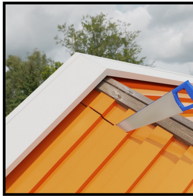
2. Sag av 6 cm i øvre del av takplaten der festeskinnen 12 skal legges.
